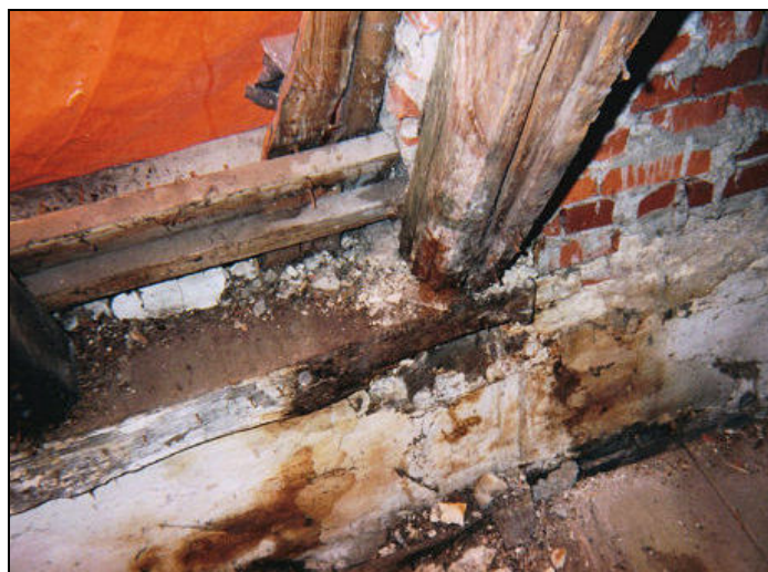
Een van de vele slechte plekken, door houtrot en lekkage. Een ingrijpende restauratie was noodzakelijk (foto collectie Ginie Arends).
